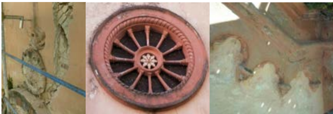
Figura 1 lastre di pietra a rilievo sul portale e saggi che rivelano una preesistenza circolare, Figura.2 Rosone in malta dipinto in rosso, Figura 3 Decorazione sommitale della facciata ad archetti, in malta dipinta in rosso
