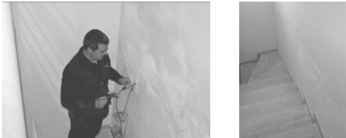
Figura 20, 21 I muri del museo impregnate dall'umidità durante le misurazioni
