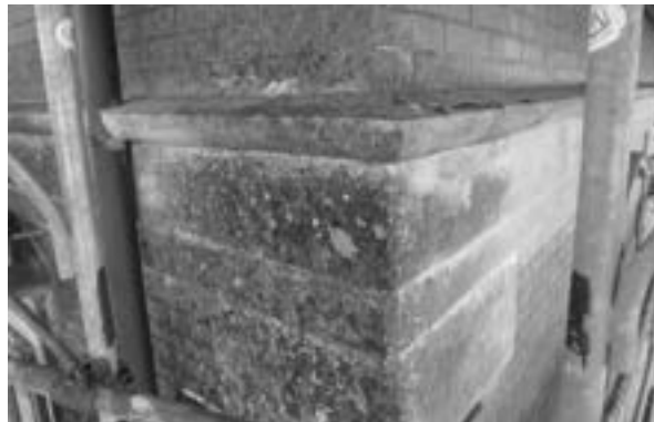
Figura 11. Dettaglio infestazione biologica sul paramento murario
