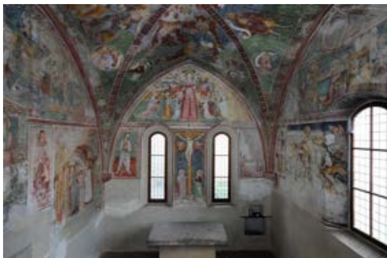
Figura 1. Interno della chiesa, coro con pitture murali. A sinistra, la parete nord soggetta ai problemi di degrado attivo che vengono discussi in questo articolo.
