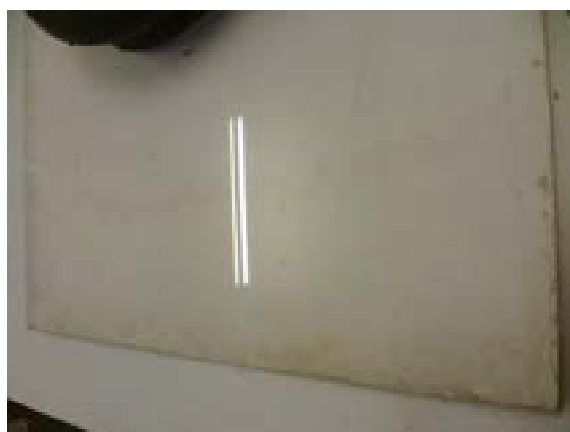
Figura 5. Particolare della gora di umidità
