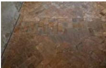
Figura 3. Dettagli dalla pavimentazione esistente colpita dall’umidità
