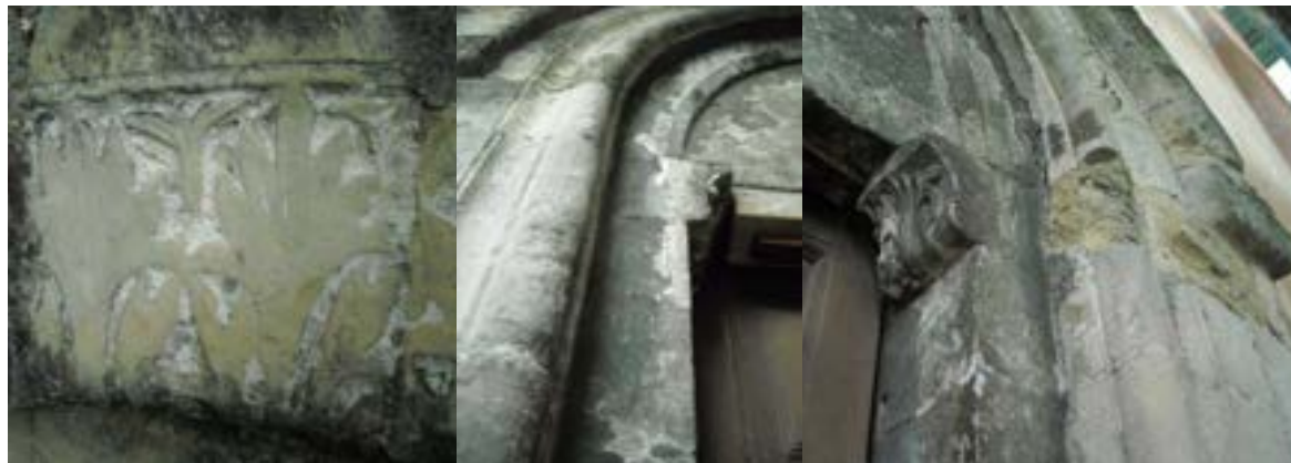
Figura 4 Strati di scialbo nelle parti di fondo dei rilievi; Figura 5 Portale coperto di scialbi e croste nere; Figura 6 Attacchi biologici, ossalati e polverizzazione della pietra in contrasto con zone pulite; (G.D.C.)
