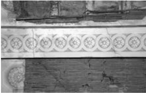
Figura 3. I crolli nel soffitto ottocentesco evidenziano la tramezza lignea sottostante
