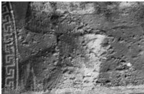
Figura 13. Sala gialla: sbollamenti e tumefazioni della malta gessosa
