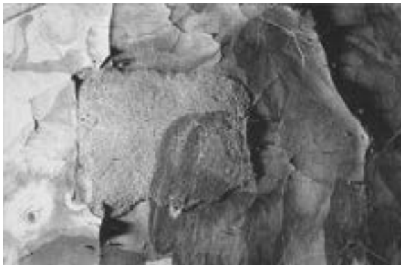
Figura 7. Sollevamenti e distacchi della gessatura con stuccatura del restauro ottocentesco.
