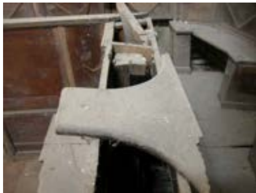
Figura 1 e 2. Immagini del degrado in cui vertevano gli elementi costituenti il coro.
