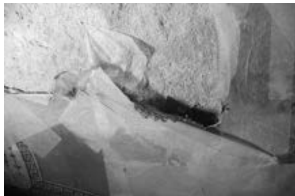
Figura 14. Sala gialla: distacco della rasatura in gesso dall'intonaco
