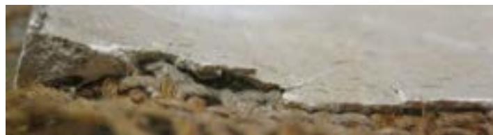
Immagine 8. La macrofotografia mostra la fratturazione tra l'area perimetrale e il centro dell'opera dovuta al diverso spessore del gesso; appaiono inoltre evidenti sia lo stato di degrado della tela di armatura che i distacchi di materiale.
