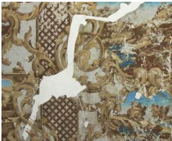
Figura 18. Stanza n. 50. Risanamento delle lacune di supporto mediante l'applicazione di carta occidentale.
