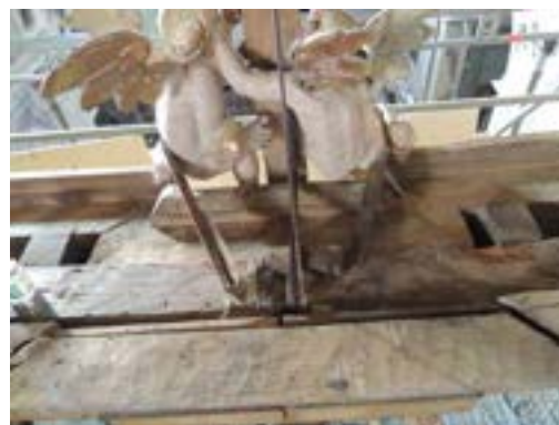
Fig 22 traversine di legno che bloccano i 2 angeli
