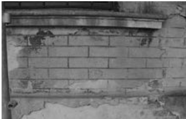
Figura 10. Dettaglio degrado generalizzato intonaco finti mattoni
