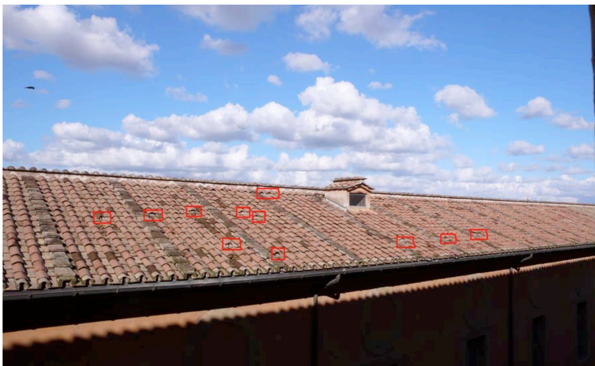
Fig. 1 – Roma: I punti di infiltrazione di acque meteoriche nelle coperture del complesso storico di San Michele, prima del restauro
