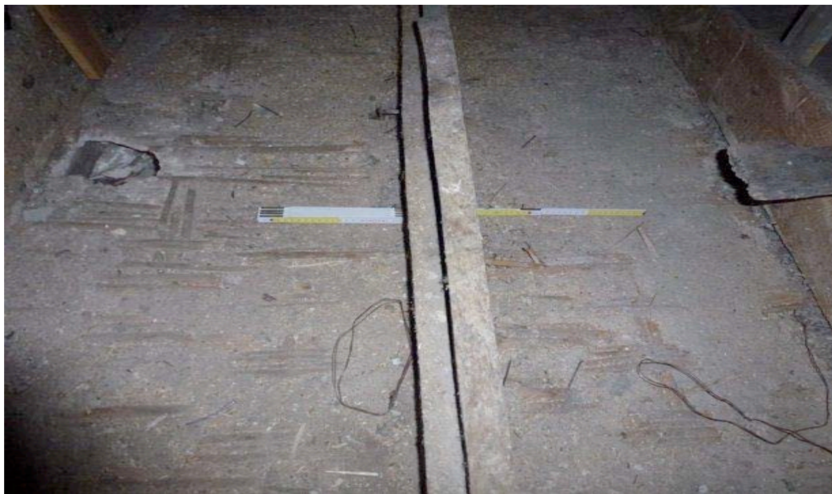
Fig. 3 – Medole, Chiesa dell'Assunzione di Maria Vergine: Particolare centinatura sulla navata centrale. Ben visibile distacco dell'incannucciato dalla struttura.
