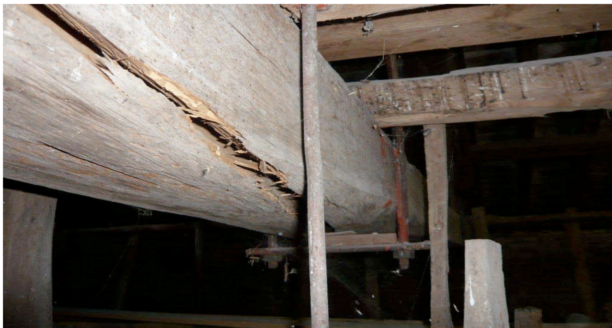
Fig. 5 – Medole, Chiesa dell'Assunzione di Maria Vergine: Lesione di una capriata dopo il sisma del 2012
