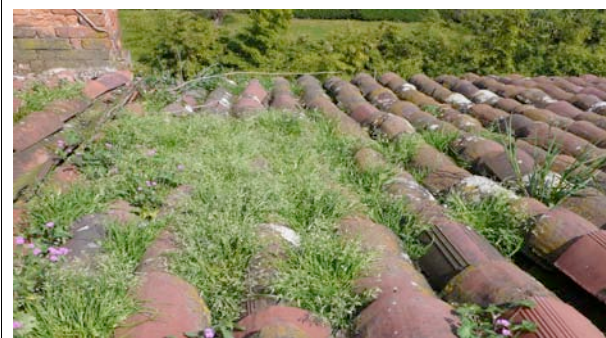
Fig. 8 – Castello di Lurano: coperture Ala Nord, esempio di muschio sulla falda Nord
