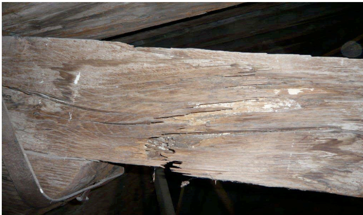
Fig. 2 – Medole, Chiesa dell'Assunzione di Maria Vergine: Catena capriata n. 6. Ben visibile il degrado dovuto a marcescenze e tarli in prossimità dell'appoggio lato est.
