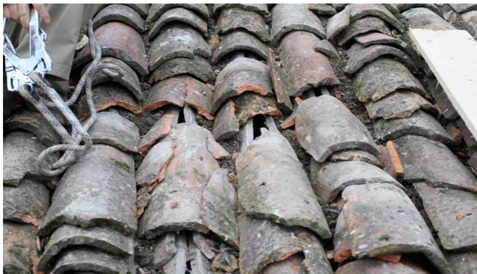
Fig. 12 – Chiesa di S. Maria in Bressanoro: esempio di coppi degradati
