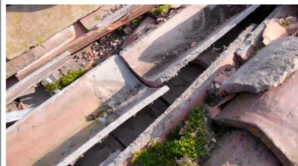
Fig. 6 – Castello di Lurano: coperture Ala Nord, esempio di scivolamento di un coppo
