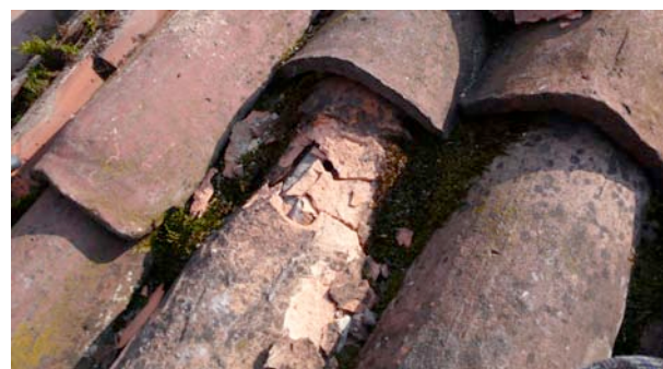
Fig. 7 – Castello di Lurano: coperture Ala Nord, esempio di coppo “frammentato”
