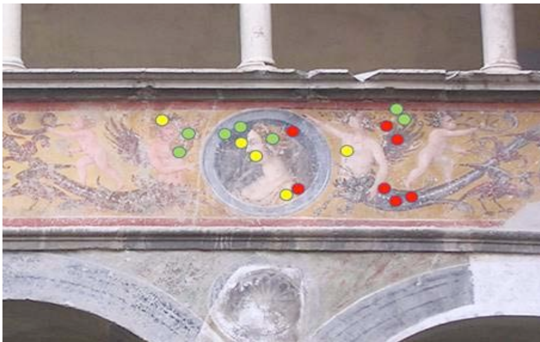
Fig. 1. Distribuzione spaziale dei DE in Palazzo Besta a Teglio (sett. 2010 – nov. 2005) valori decrescenti dal rosso al verde
