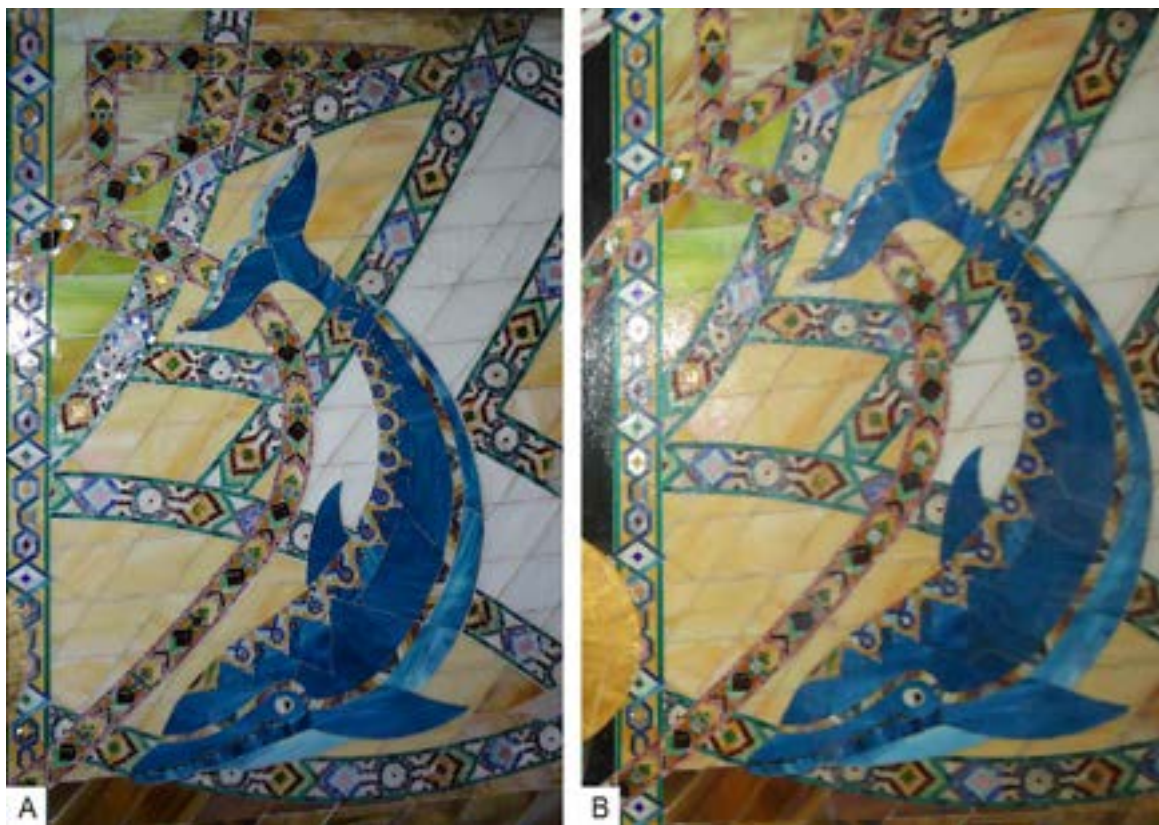
Figura 7. Immagine del particolare del delfino eseguito con tecnica a mosaico con tessere vitree: A privo di messa in sicurezza; B con messa in sicurezza
