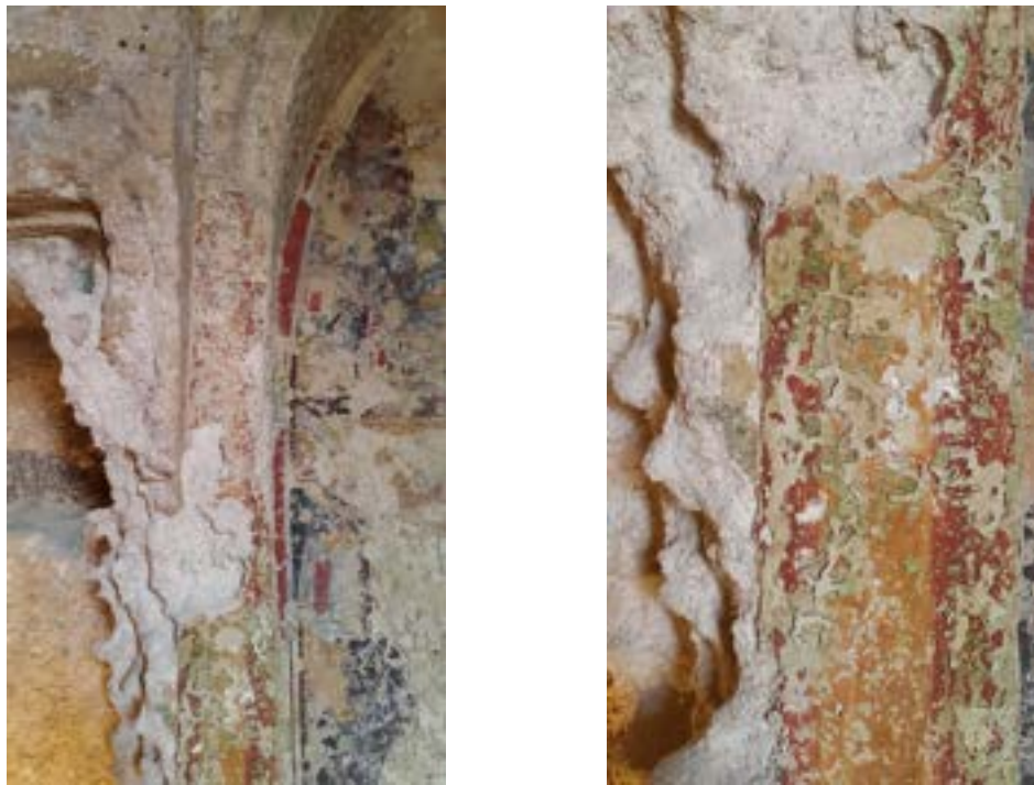
Figure 14 e 15. Convicinio di S. Antonio, Cripta di S. Donato. Particolare dei difetti di coesione e adesione del supporto, costituito dal banco roccioso, al di sotto dei palinsesti (foto autori)
