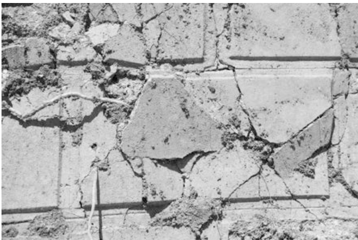
Figura 2. Particolare dell'intonaco. Azione meccanica delle radici che ha provocato la rottura della formella.
