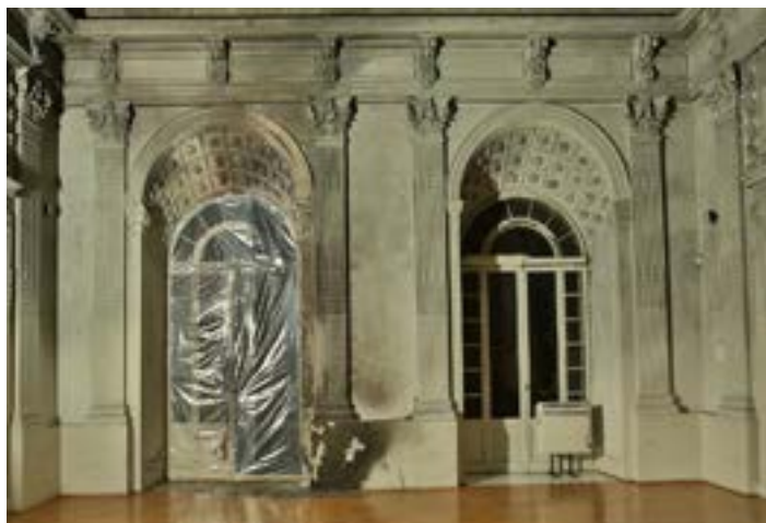
Figura 1. Parete dalla quale si è innescato l'incendio.
