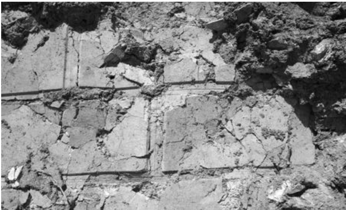
Figura 13. Particolare dell'intonaco prima del restauro
