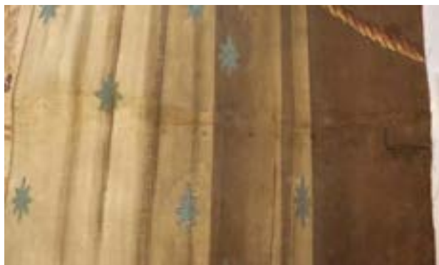
Figura 24. Segni dello stangone e inserti in corrispondenza
