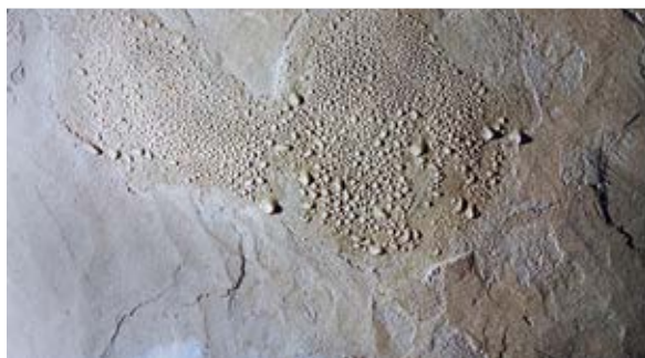
Figura 7. Episodio di condensa sulle stuccature di restauro.
