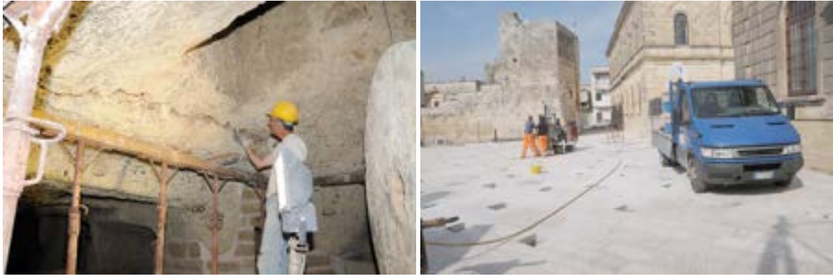
Figura 14. Lesione passante sull'intradosso della copertura (© A. Monte, 2013);
