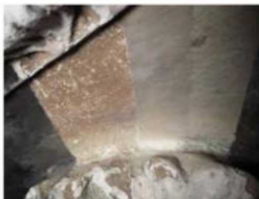
Figura 4. Si nota in basso una zona con un'alterazione dovuta alla barriera protettiva dal rilievo durante l'incendio
