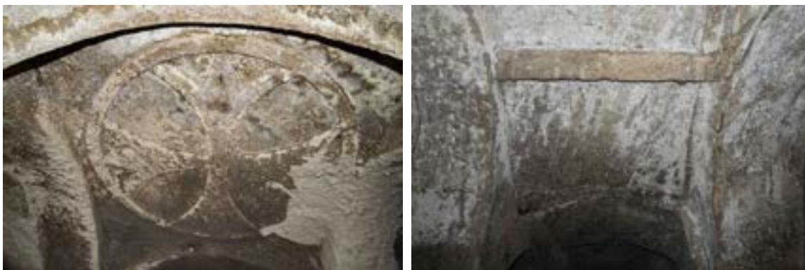
Figure 19 e 20. Convicinio di S. Antonio, Cripta di S. Antonio Abate. Particolare dei gravi fenomeni di disgregazione e scagliatura degli elementi scolpiti e delle fessurazioni naturali della pietra
