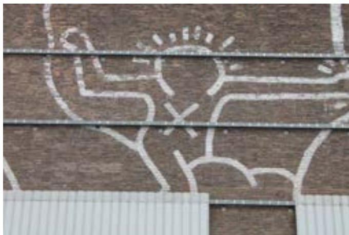
Particolare dell'opera con giunti metallici sovrastanti la pellicola pittorica
