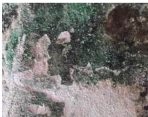
Figura 18. Chiesa di S. Lucia alle Malve. Particolare dei fenomeni di disgregazione della pietra al di sotto delle patine biologiche (foto autori)
