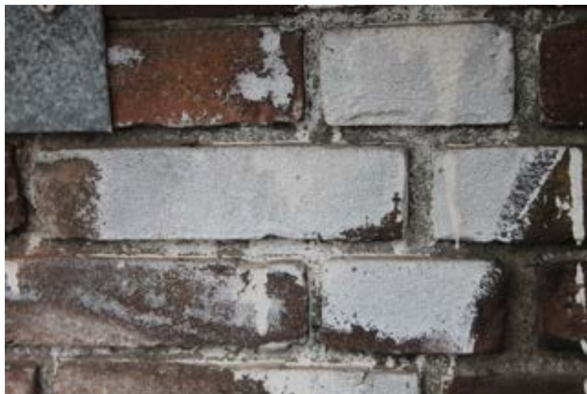
Foto del degrado subito dalla pellicola pittorica
