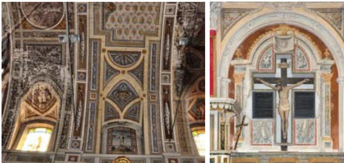
Figure 2 e 3. Condizioni volta a botte lignea campata verso abside e campata uscita aria calda, grate uscita aria calda impianto di riscaldamento inserite a fianco del Crocefisso ligneo datato 1598.
