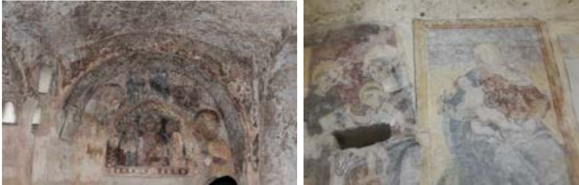
Figura 12 e 13. Convicinio di S. Antonio, Cripta di S. Eligio. Particolare degli affreschi con efflorescenze e subefflorescenze saline. Chiesa di S. Agostino. Particolare dei dipinti murali interessati da carbonatazioni sulla pellicola pittorica (foto autori)
