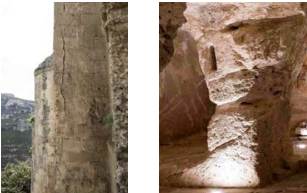
Figura 5 e Figura 6. Lesione subverticale lungo il prospetto NE di S. Pietro Caveoso (foto di Edoardo Loliva, fotografo ISCR) e fratture del banco roccioso in S. Giovanni in Monterrone (foto autori)
