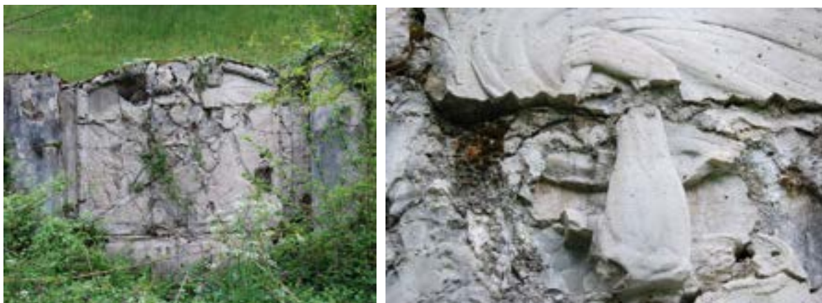
Figura 3 e 4. A sinistra stato di conservazione dell'opera nel 2015. A destra esempio di riassetto sconnesso realizzato forse a seguito del terremoto del 1976.
