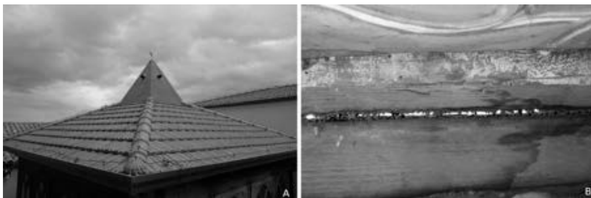
Figura 1. A; Nuova copertura della Sala dei Venti, da notare il colmo con il sistema di aerazione a ventilazione naturale; B: distacchi presenti tra le travi di sostegno della struttura lignea.
