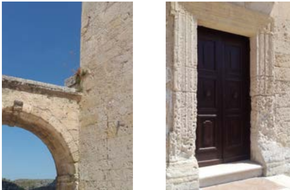
Figura 10 e 11. Chiesa di S. Pietro Caveoso. Particolare della vegetazione spontanea cresciuta all'interno di una fessurazione e dei fenomeni di erosione e alveolizzazione della calcarenite organogena (foto autori)
