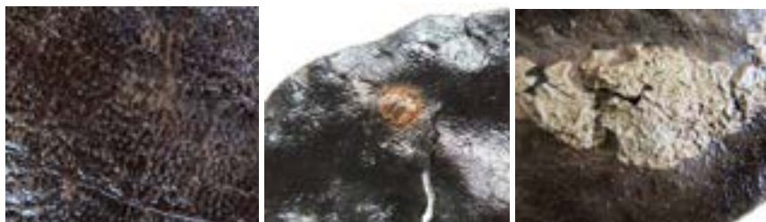
Figure 12, 13, 14. Depositi di sedimenti limosi; macchie da prodotti di corrosione del ferro; incrostazioni.
