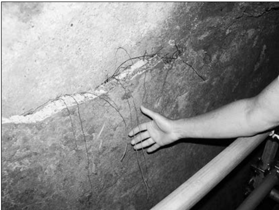
Le radici degli alberi posti nel giardino sovrastante fuoriescono da dietro l'intonaco
