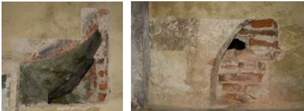
Figure 12 e 13. Saluzzo (CN). Chiesa di San Giovanni. IV-V campata della navata laterale sinistra. Particolari della nicchia e dell'apertura emerse a seguito della campagna conoscitiva che ha riguardato le superfici in oggetto
