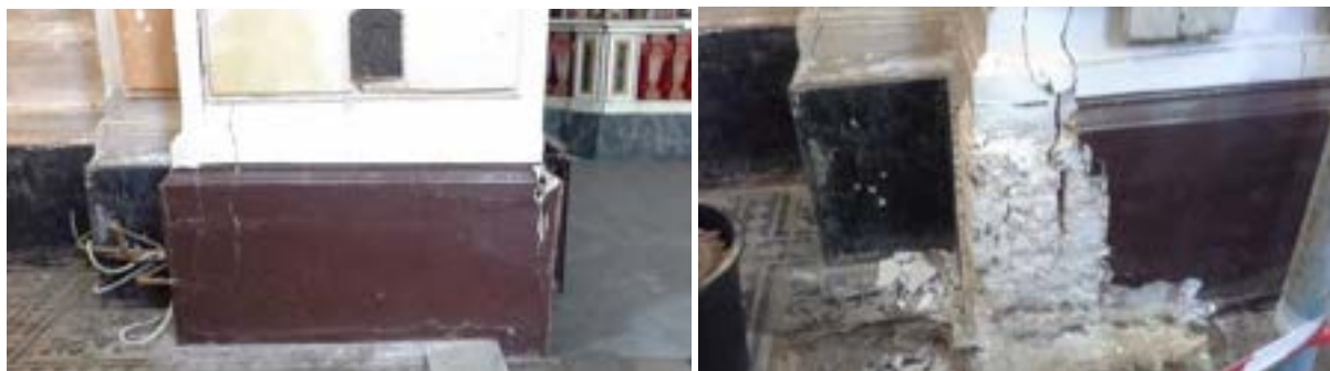
Figure 12 e 13. Interno dell'aula. Lesioni da schiacciamento per pressoflessione al piede del pilastro.
