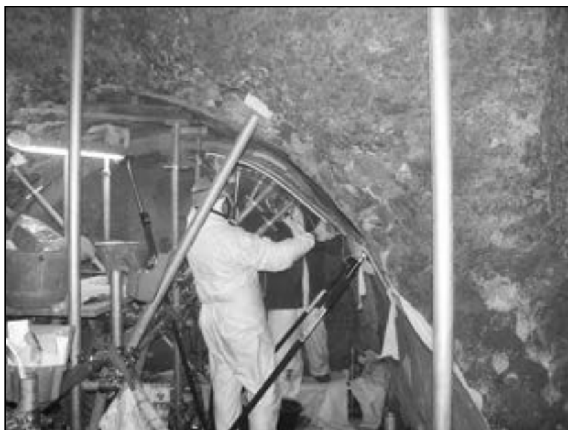
Stacco di una sezione di intonaco
