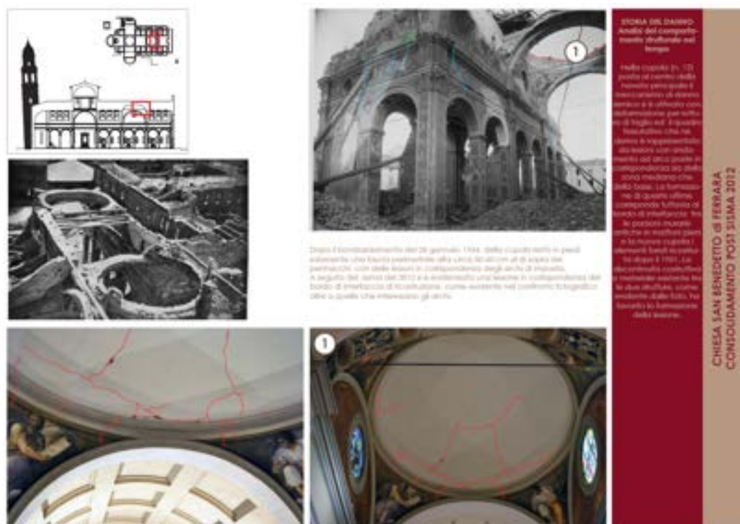
Figura 3. Storia del danno. Analisi del comportamento strutturale nel tempo. Il quadro fessurativo della calotta mediana della navata principale
