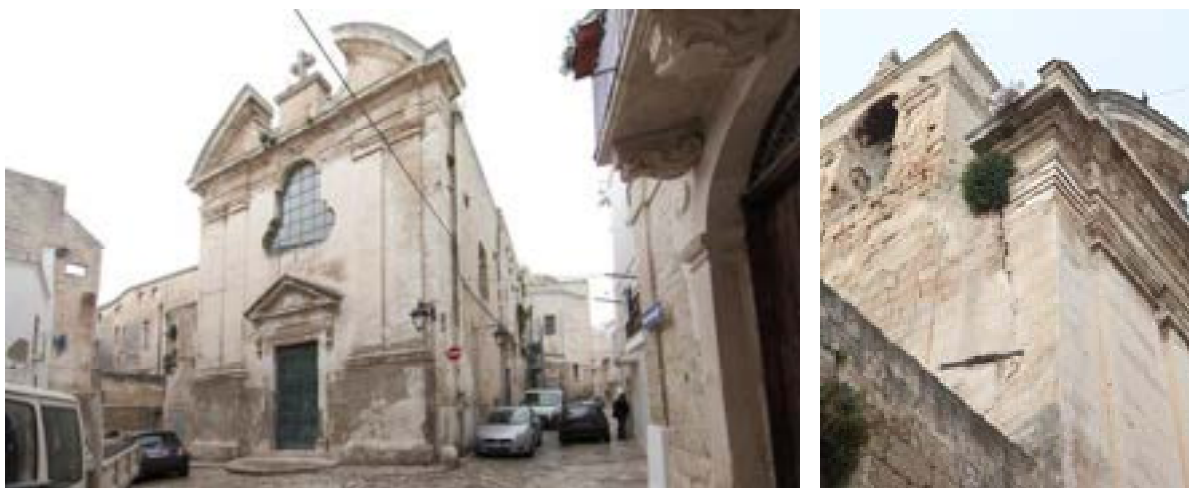
Figure 1 e 2. La chiesa di Sant'Angelo in Borgo a chiusura dell'isolato. Lesione da ribaltamento della facciata.
