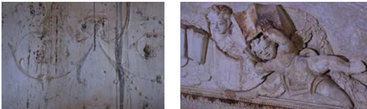
Figure 1 e 2. Schizzi di calce e cemento. Macchie causate dal deposito di guano.
