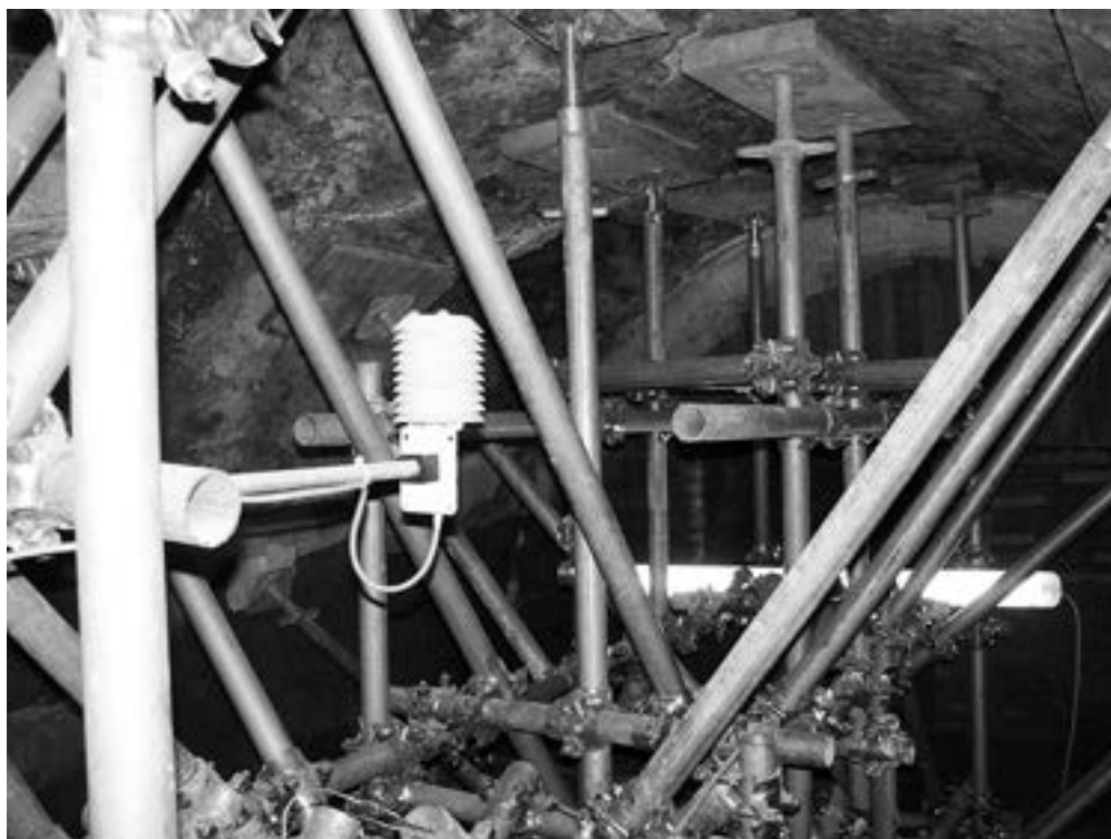
Una delle due sonde termoigrometriche poste nell’area di lavoro
